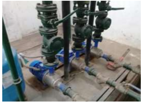
Vista del sistema de bombeo del agua potable. 2 electrobombas y el tanque hidroneumático
