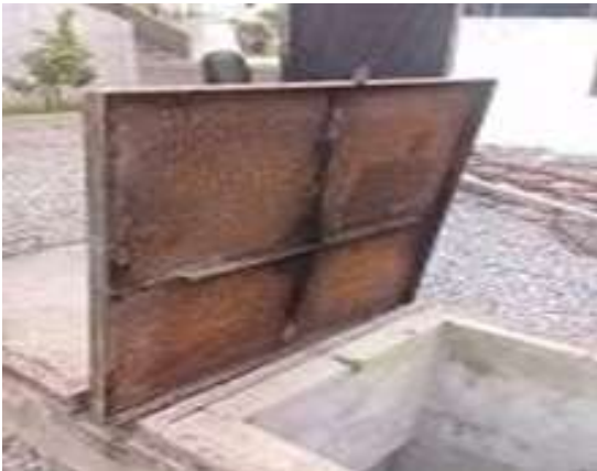
Compuertas de las cisternas
